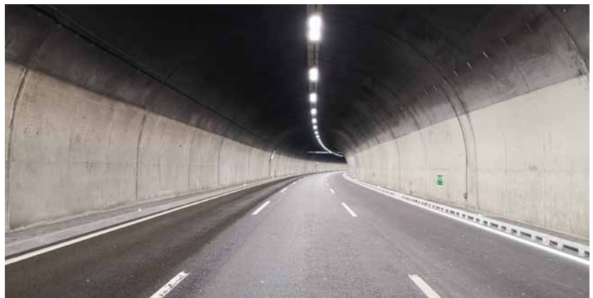
LED-Beleuchtung im Monte-Ceneri-Tunnel.
